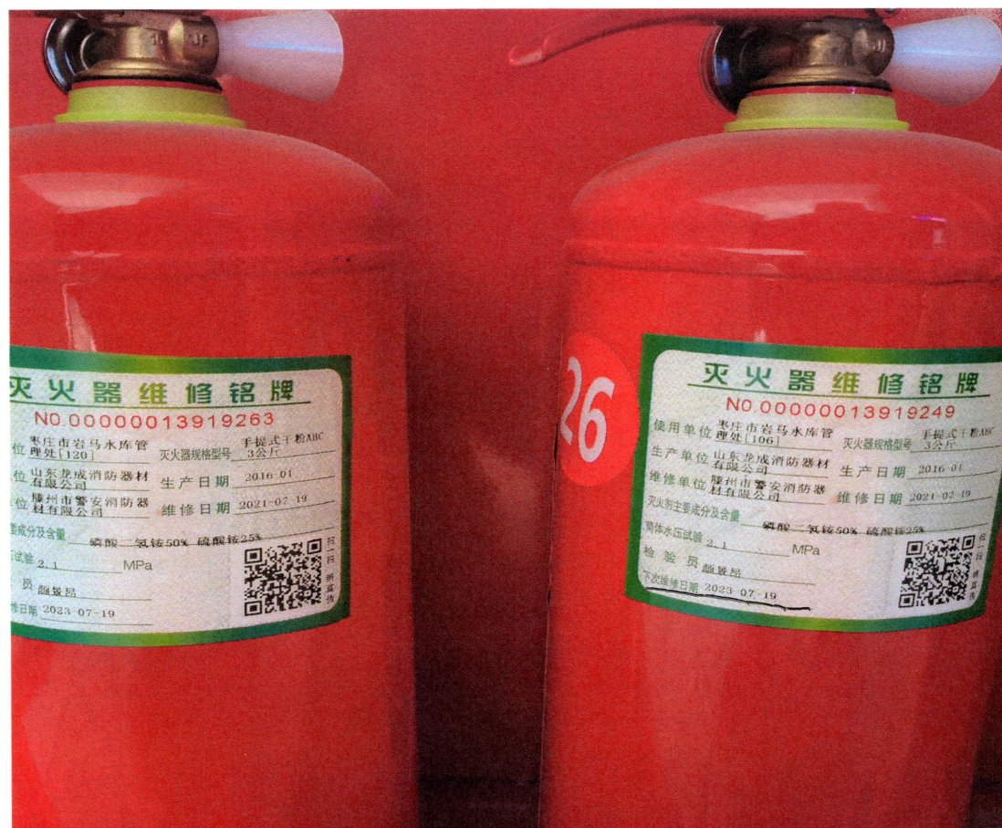
注释：灭火器年检照片
