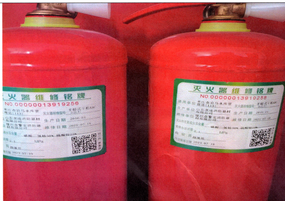
注释：灭火器年检照片
