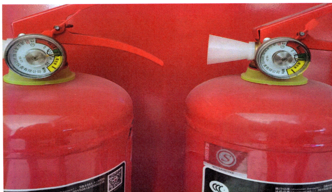
注释：灭火器年检照片
