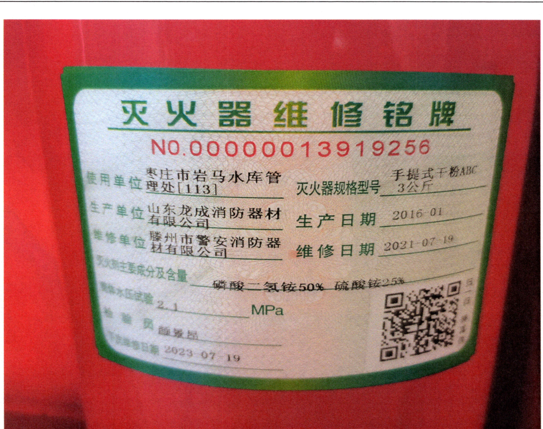
注释：灭火器年检照片
